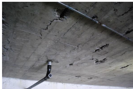
Sixty-01 Slab Decay
